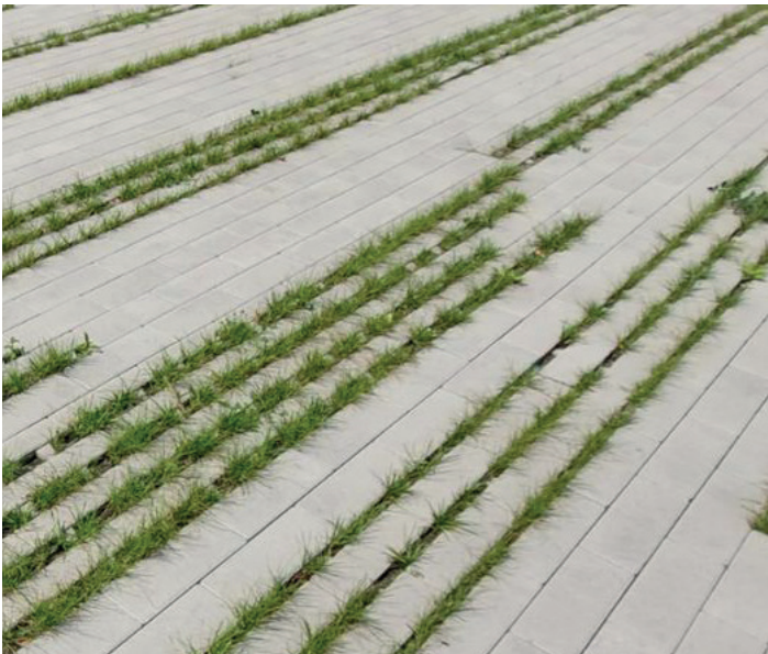
Rasenliner (Auflösung des Belags bei Zufahrten)
